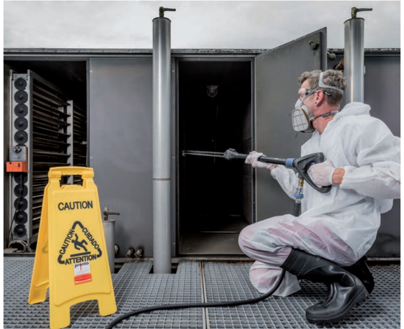
Dank konsequenter Reinigung können Haustechnikanlagen ihr Energiespar-Potenzial optimal entfalten.
